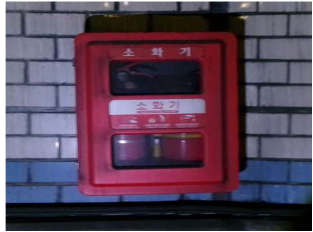
방재시설(소화기) S01 상태현황
