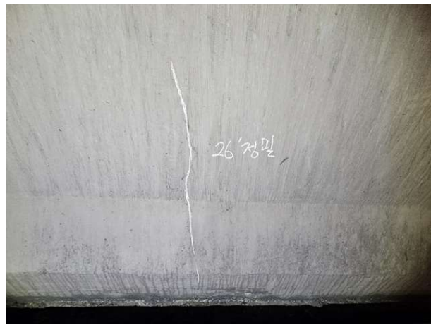
안전 및 기타시설(하부 방호벽(좌)) S1 균열(0.3mm미만)
