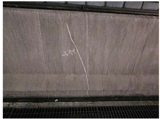
안전 및 기타시설(하부 방호벽(좌)) S1 균열(0.3mm미만)
